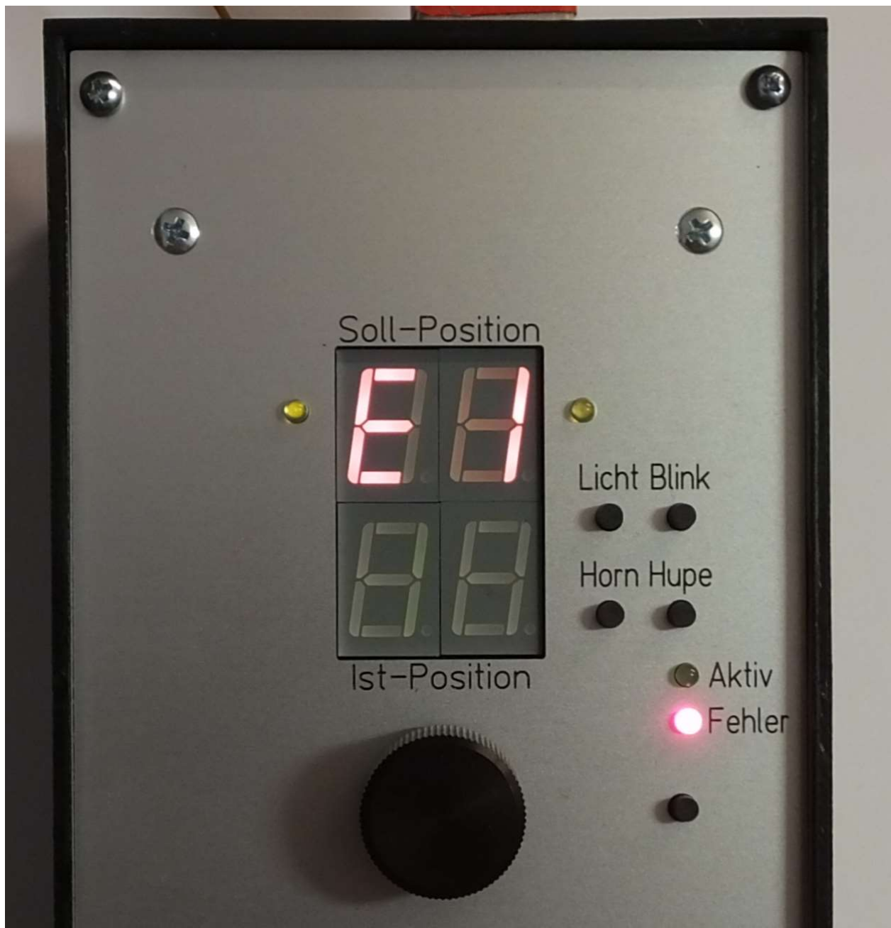
Abbildung 2: Fehler "E1" (die Bühnen ist noch nicht an die Grube angeschlossen)
